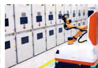
高压配电柜操作
