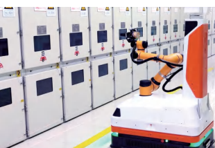
高压配电柜操作
